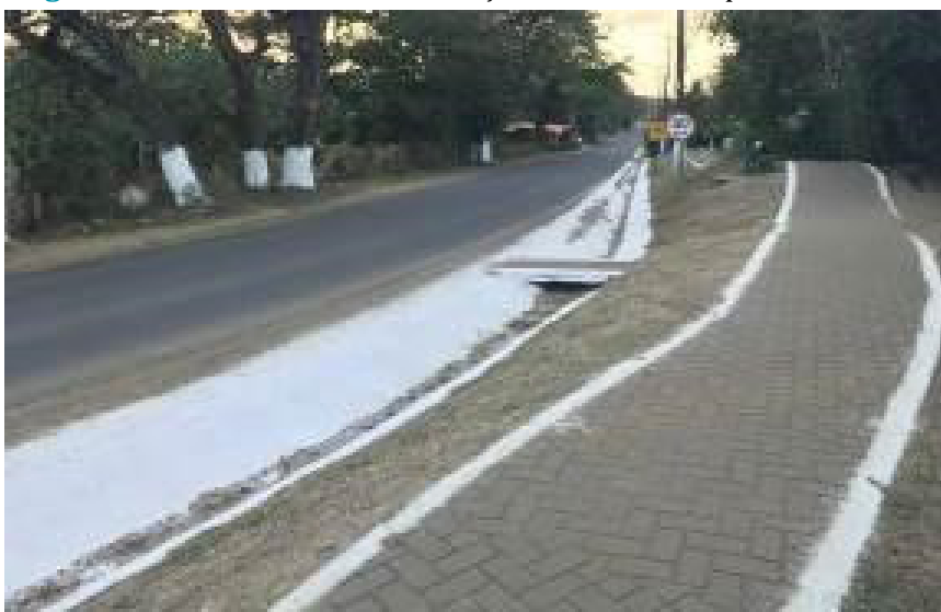
Figura 12 – Inexistência de sinalização horizontal em parte da BR-363
